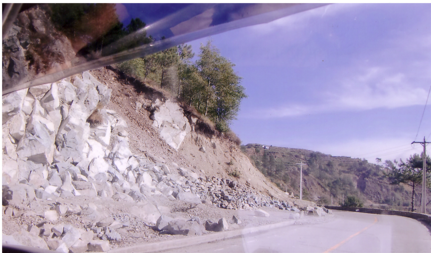
斜面は雨のたびに崩れる
